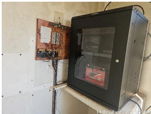
Imagem 8. Repetidora de sinal instalada – Área da Piscina
