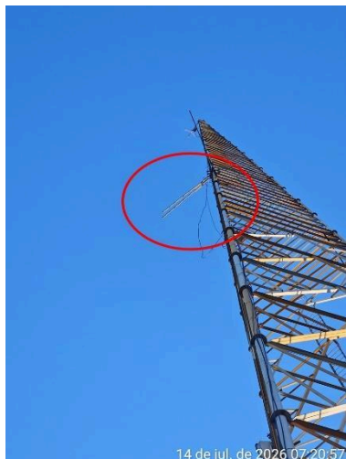
Imagem 7. Antena instalada – Área da Piscina (destacada em vermelho)
