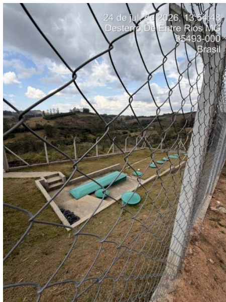
Estação de Tratamento de Esgoto (ETE)
