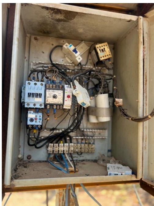
Imagem 4. Painel de captação de água.
