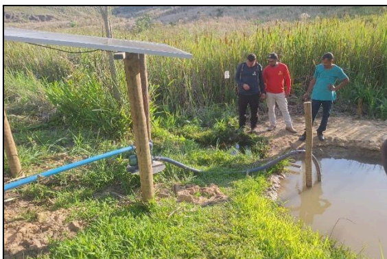
Sistema de bombeamento com placas solares.
