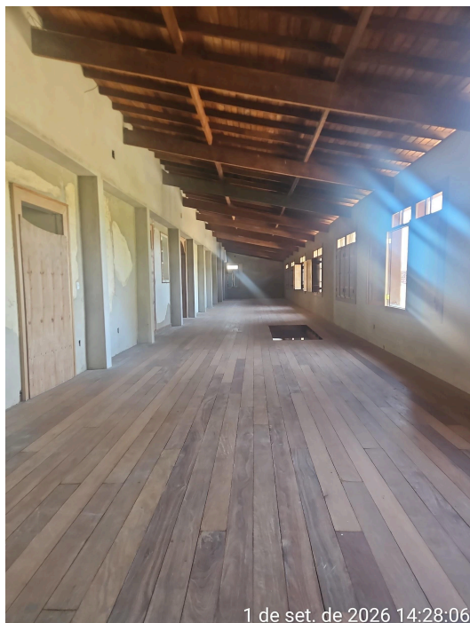
Imagem 9. Trecho que passou por reforma emergencial
