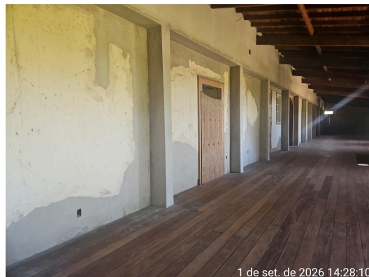
Imagem 10. Trecho que passou por reforma emergencial
