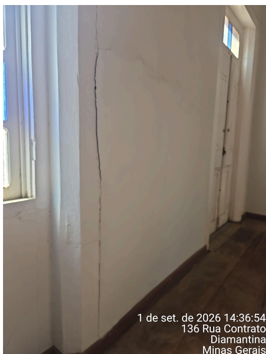
Imagem 5. Trinca observada em alvenaria Autoria: Maria Letícia Ticle Data: 01/09/2026
