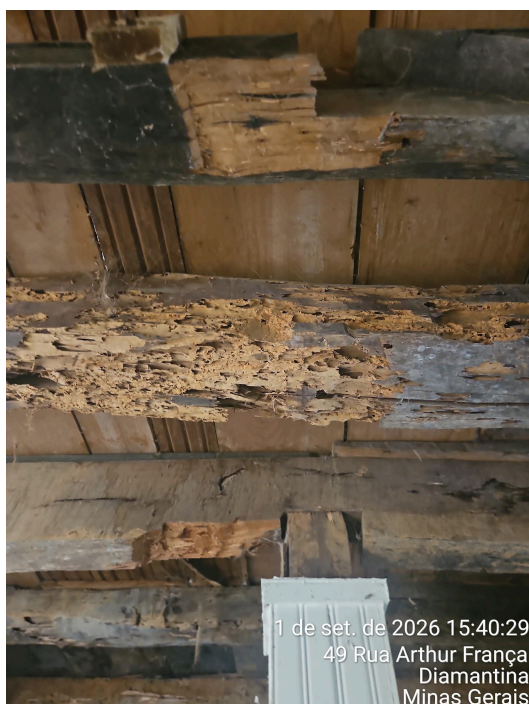
Imagem 7. Peças da estrutura de madeira em estado de degradação avançado Autoria: Maria Letícia Ticle Data: 01/09/2026
