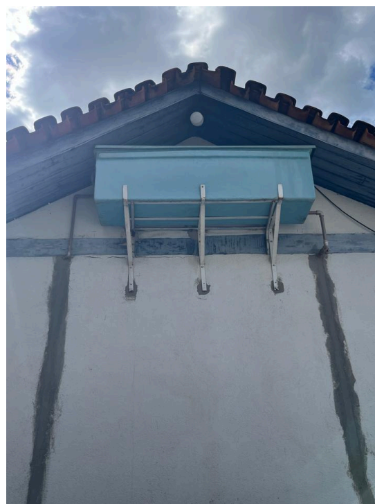
Caixa d'água improvisada instalada na parte posterior da Capela Data: 11/09/2026 Autoria: Natália Morita
