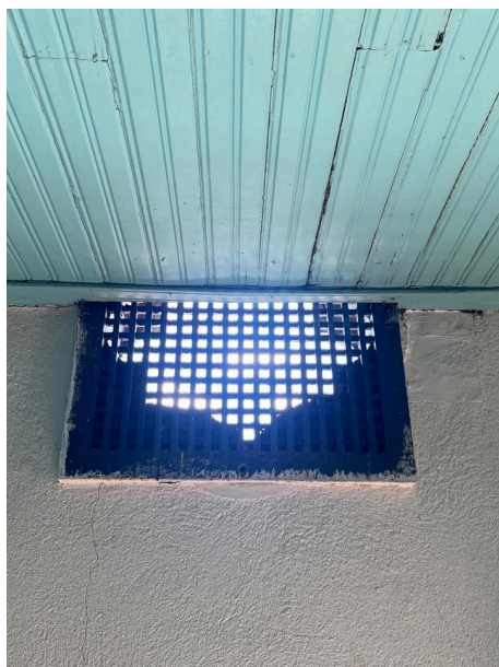
Óculo tapado com o forro colocado em intervenção anterior
