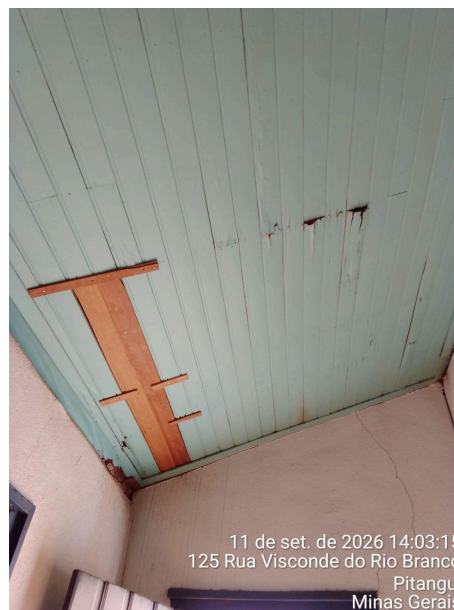
Forro colocado posteriormente no corredor lateral
