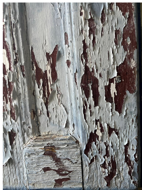
Detalhe da perda de policromia e ressecamento da janela da Capela
