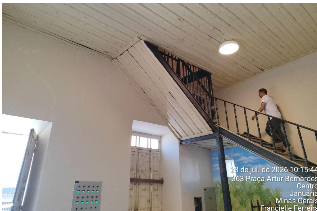
Sistemas elétricos, luminotécnicos instalados na edificação Autoria: Francielle Ferreira Data: 28/07/2026
