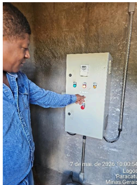
Imagem 6. Casa de bomba Autoria: Carolina Rodrigues Bordignon Data: 07/05/2026
