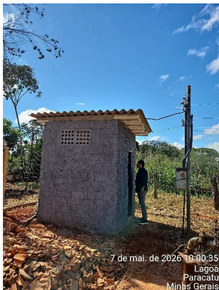
Imagem 5. Casa de bomba Autoria: Carolina Rodrigues Bordignon Data: 07/05/2026
