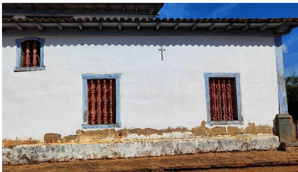
Detalhe do reboco no embasamento em uma das fachadas laterais Autoria: Francielle Ferreira Data: 09/05/2024
