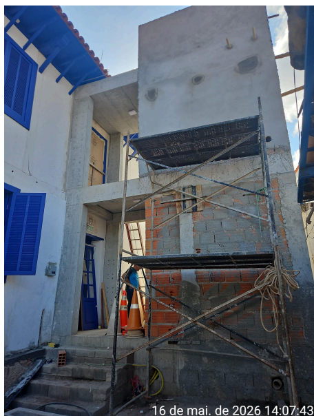
Imagem 6. Torre para instalação da plataforma de elevação - vista externa Autoria: Maria Letícia Ticle Data: 16/06/2026
