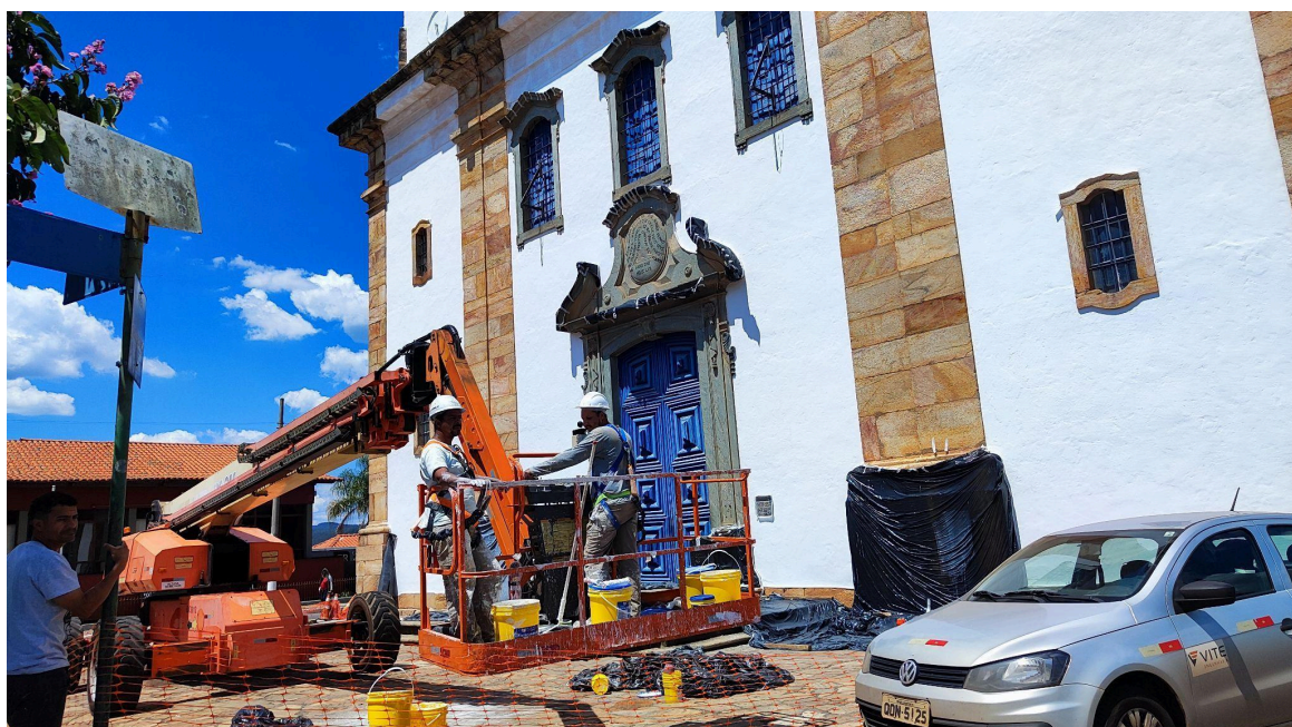
Plataforma Elevatória utilizada para execução dos serviços externos - pintura, infraestrutura elétrica e SPDA. Autoria: Francielle Ferreira Data: 27/11/2024
