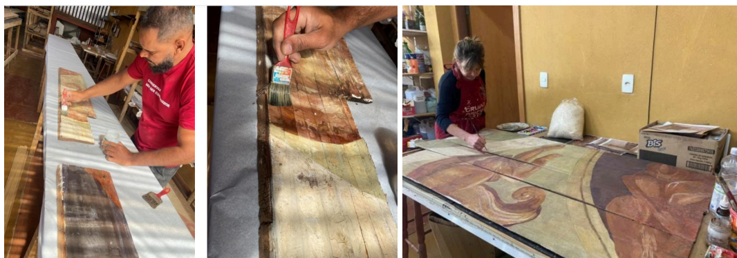
Restauração do forro da nave - Imagens Relatório Técnico de Prestação de Contas Autoria: Grupo Oficina de Restauro - empresa contratada pela ADERI Data: 2024
