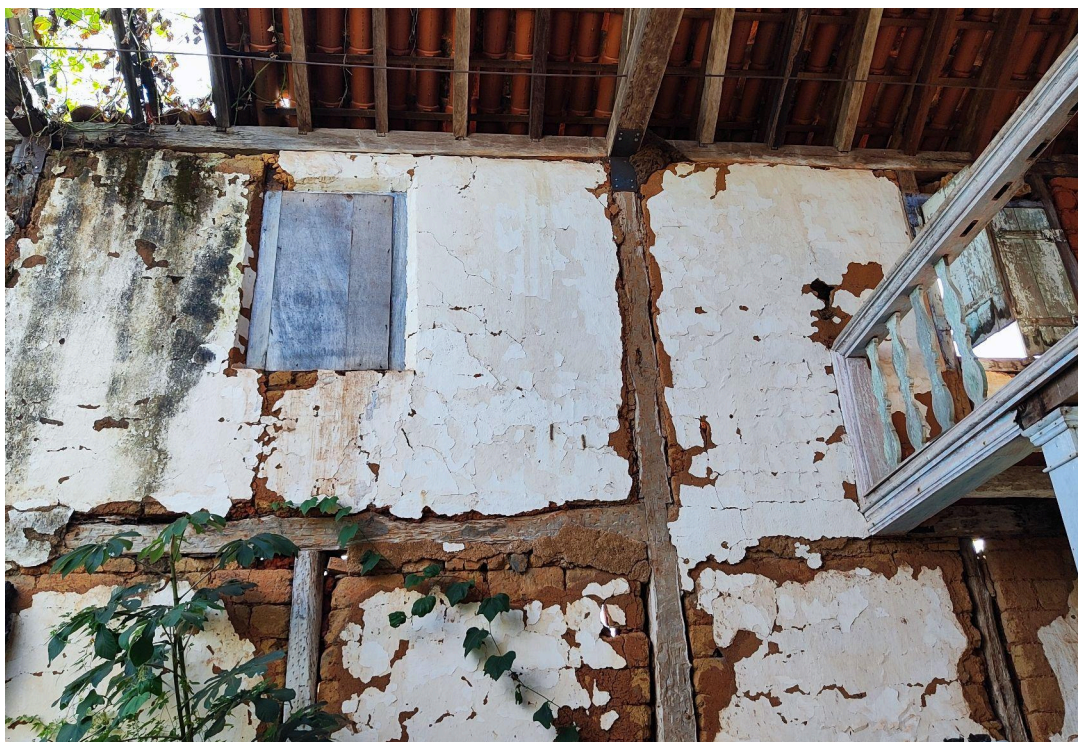
Vista da nave lado da epístola - danos estruturais visíveis e vestígios do incêndio Autoria: Francielle Ferreira Data: 07/05/2026
