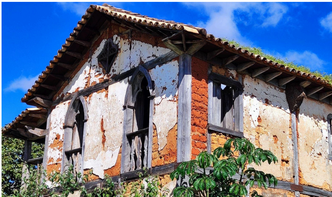
Vista da edificação - danos estruturais visíveis como trincas e deslocamento de reboco Autoria: Francielle Ferreira Data: 07/05/2026
