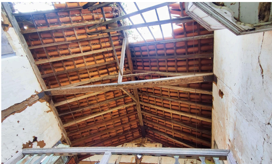
Vista da cobertura remanescente da nave - risco de colapso estrutural Autoria: Francielle Ferreira Data: 07/05/2026
