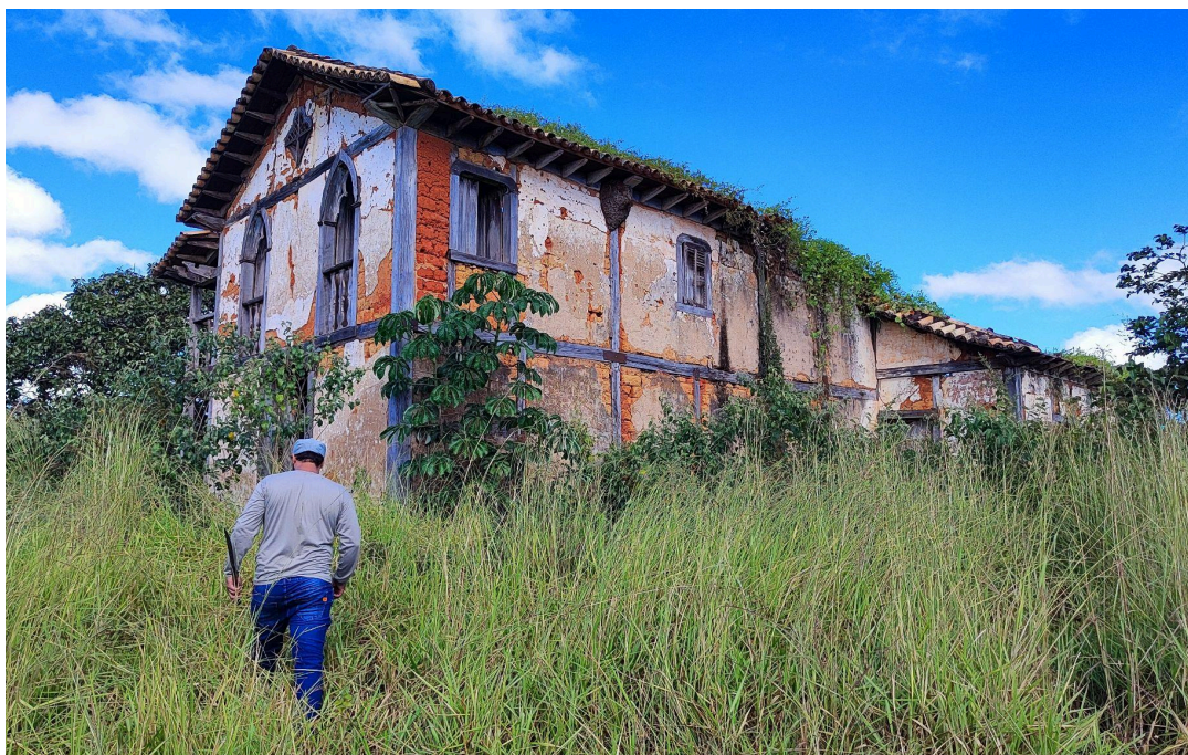
Arredores da edificação cercado por vegetação, comprometendo o acesso Autoria: Francielle Ferreira Data: 07/05/2026
