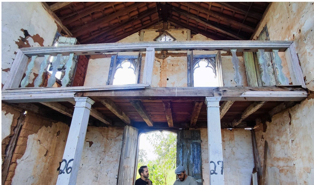
Vista do coro e átrio - danos estruturais visíveis Autoria: Francielle Ferreira Data: 07/05/2026
